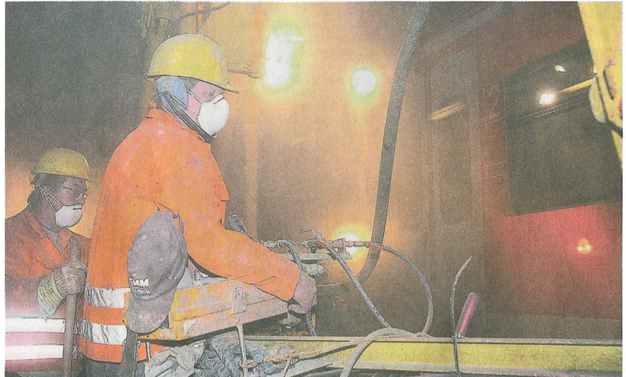
In einem aufwändigen Verfahren wird die Entwässerung im 1200 Meter langen Tunnel saniert.
